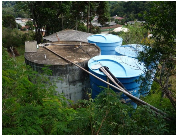
Foto 21 – Conjunto de Reservação 01
