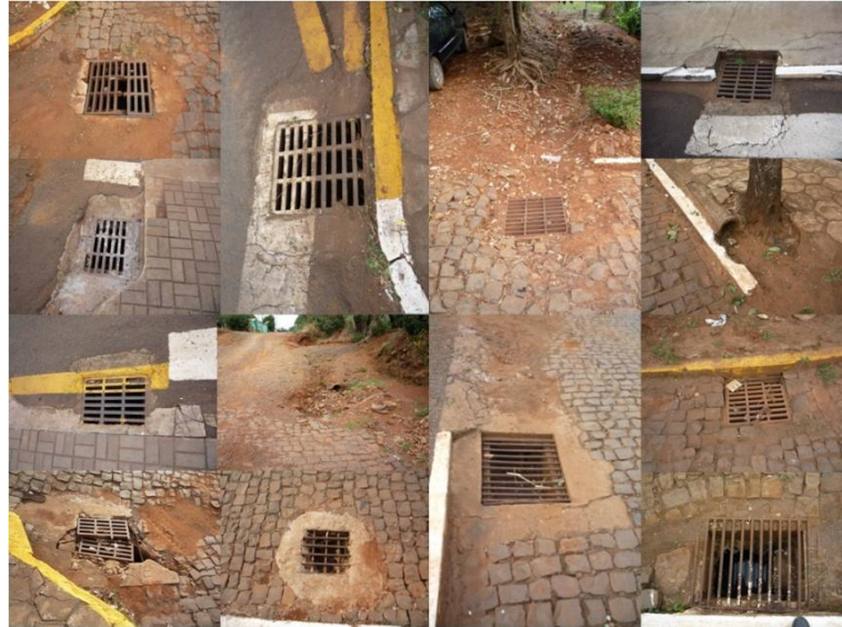
Foto 30 – Coletor de águas pluviais
