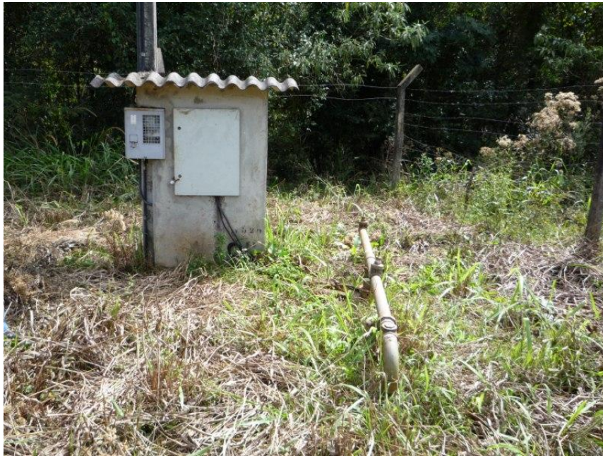
Foto 7 – Manancial Subterrâneo – Poço 01
