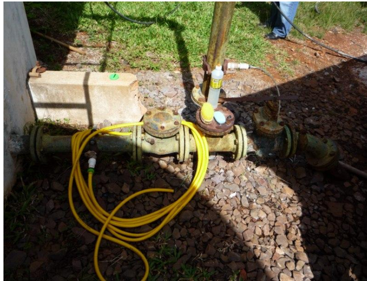
Foto 12 – Adutora de água bruta de ferro fundido 75 mm enterrada da U.T.S.
