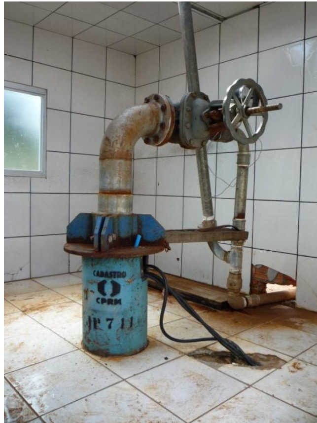
Foto 6 – Manancial Subterrâneo principal – Poço 02
