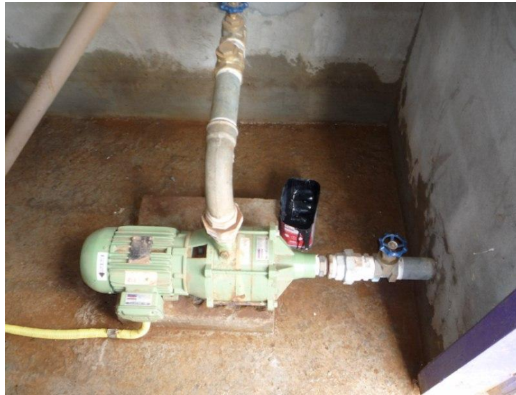
Foto 20 - Conjunto moto-bomba ERAT Res. 01
