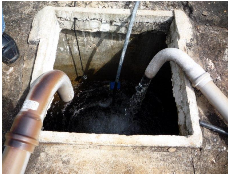
Foto 13 – Reservatório de contato com capacidade para 50 m 3
