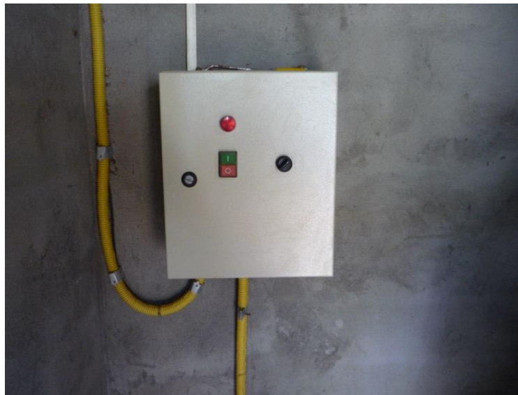
Foto 19 – Quadro comando ERAT Res. 01
